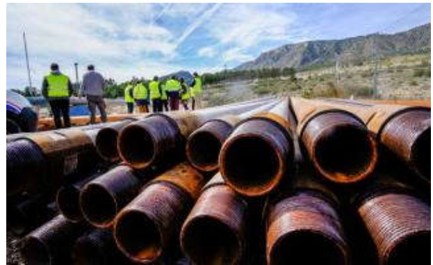
Canalizaciones de agua en el pozo Regina, que puede aportar un importante caudal. Áxel Álvarez
