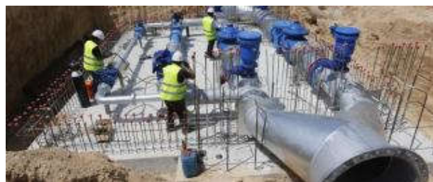
La nueva infraestructura para reducir la presión del agua en la red de regadío. antonio amorós
