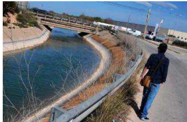
Uno de los canales de riego del trasvase Tajo-Segura en la Vega Baja. LOÍNO
