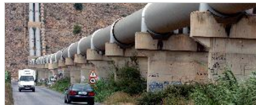
CANALIZACIÓN. Tuberías de gran tamaño que forman parte del trazado del trasvase Tajo- Segura, a su paso por Rincón de Bonanza, en Orihuela. / V. VICENS
