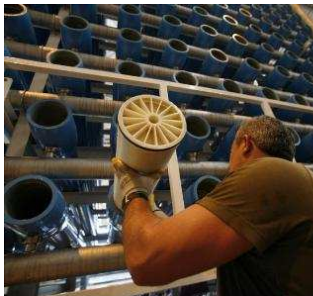
Un operario trabaja en uno de los siete bastidores de la desaladora Alicante II donde se tratará el agua del mar CRISTINA DE MIDDEL
