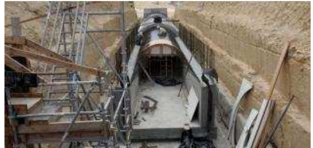
Las obras del postrasvase en Elche, en una imagen de hace unos meses. diego fotógrafo
