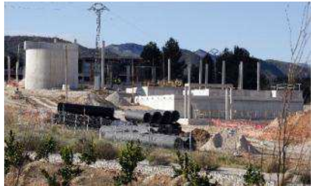
Obras de la potabilizadora que el Consell ejecuta dentro del plan de abastecimiento. vicent m. pastor
