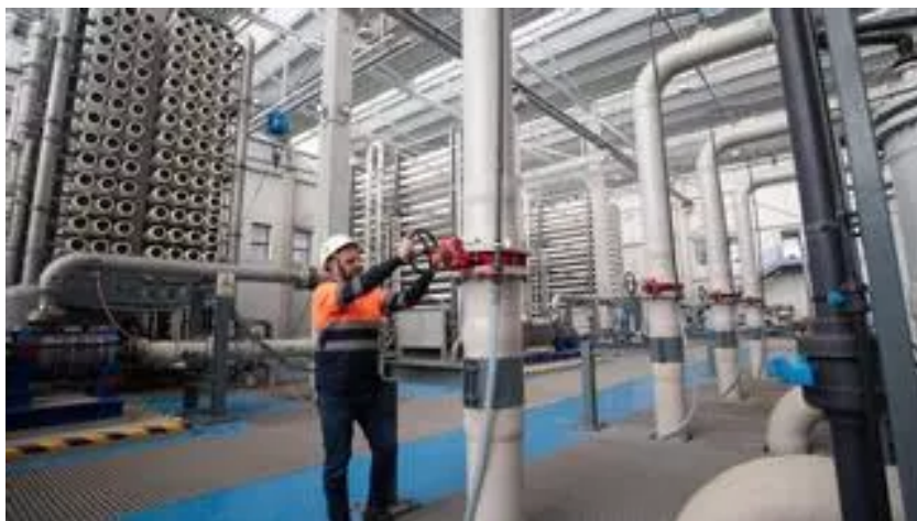
Un operario dentro de la planta desaladora de Sagunt en una imagen reciente. / DANIEL TORTAJADA
