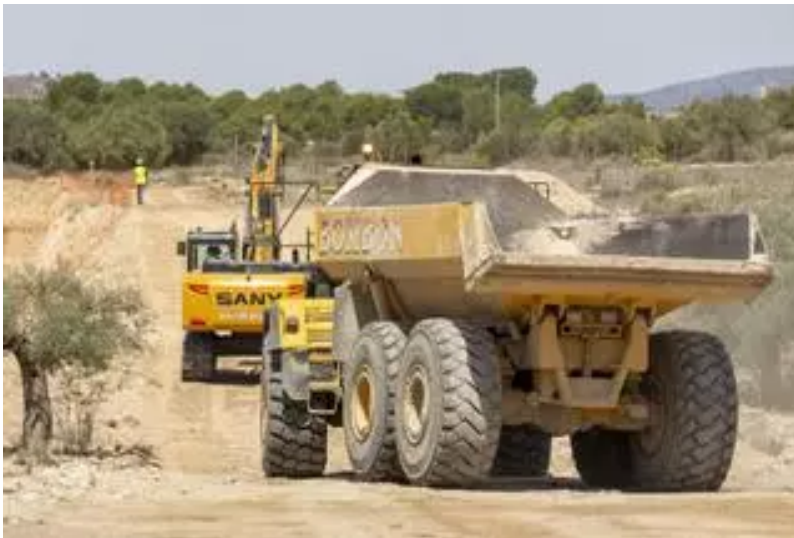
Obras del postrasvase del Júcar en la Margen Izaquierda que están en ejecución / ALEX DOMÍNGUEZ
