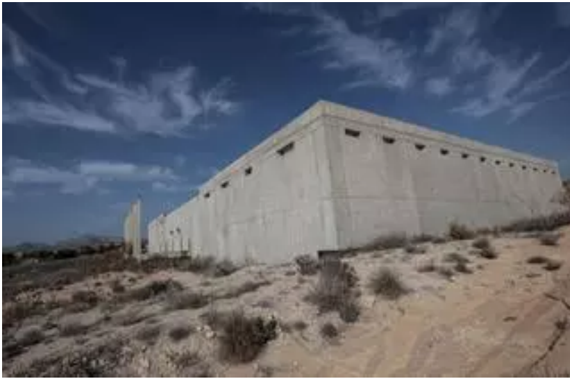
Depósito que quedó a medio construir en Mutxamel por las obras paralizadas en 2016, ubicado frente al aeródromo / HÉCTOR FUENTES
